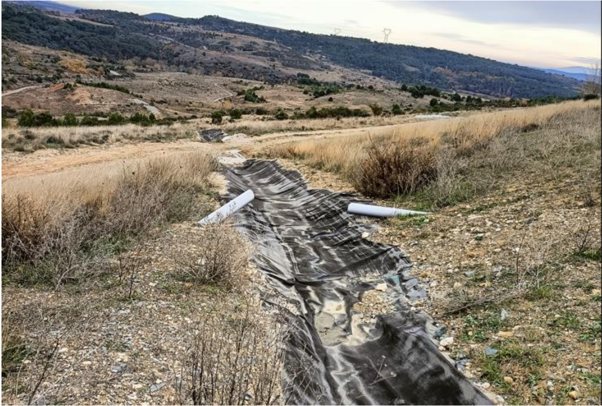
Point d'observation 11 : Erosion des matériaux en amont et au niveau de l'ancrage du DEDG
