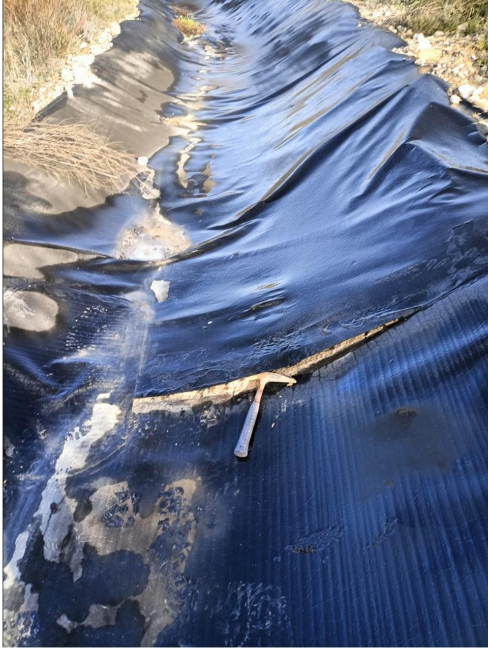
Zone 6 : Ouvrage hydraulique associé avec désordre
