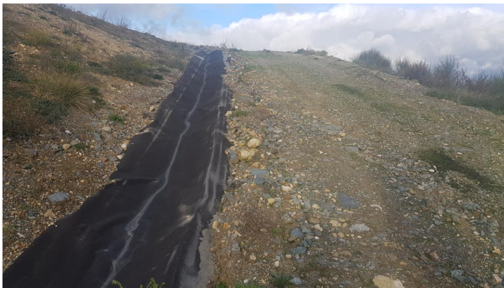
Point d'observation 1 en janvier 2022 : fossé avec traces d'érosion latérales
