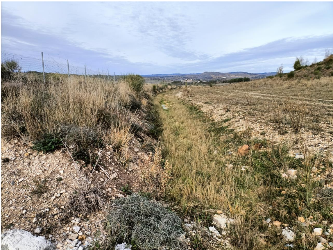
Point d'observation 8 vers le Nord /Ouest : fossé reprofilé et recalibré avec zones de stagnations d'eau résiduelles
