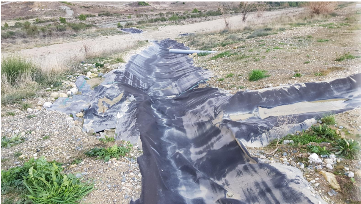
Point d'observation 12 (janvier 2012) : Erosion des matériaux en amont et au niveau de l'ancrage du DEDG
